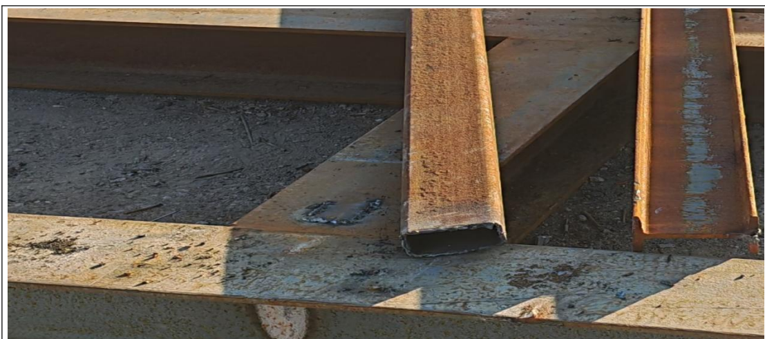
图 5 临时支撑立柱方管断裂现场照片
